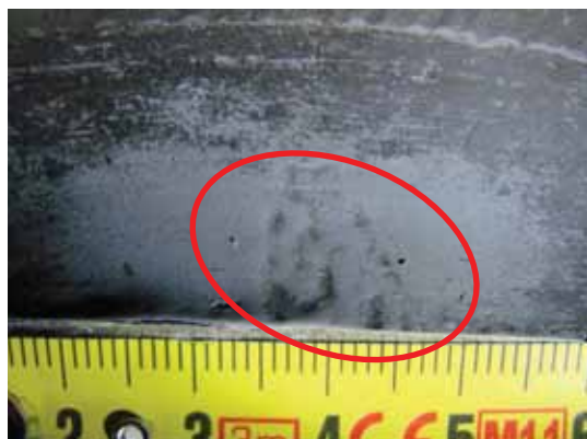
Photo 8: Défaut de surface n°2 avant décapage
