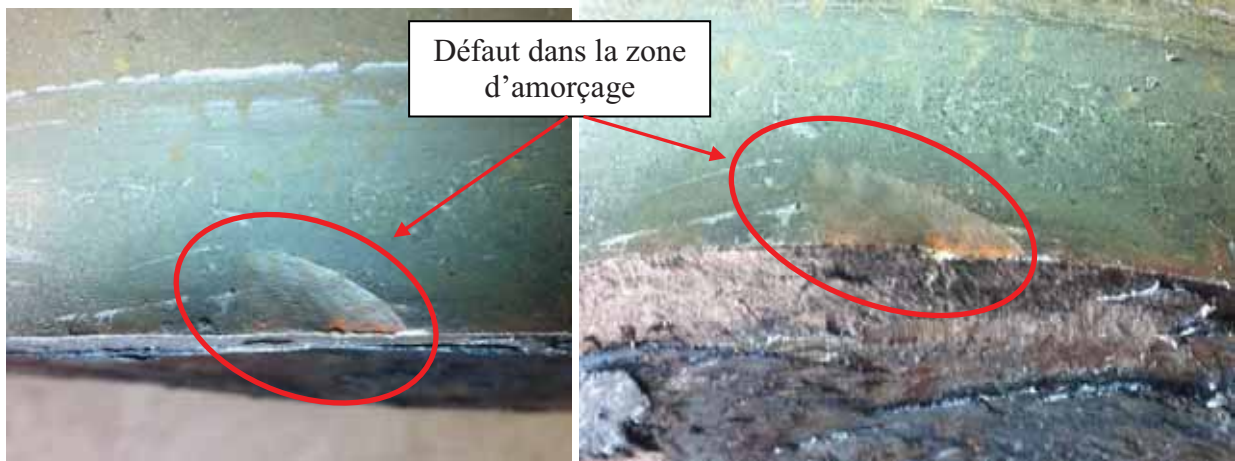
Photo 2: Défaut n°1 dans la zone d'amorçage
