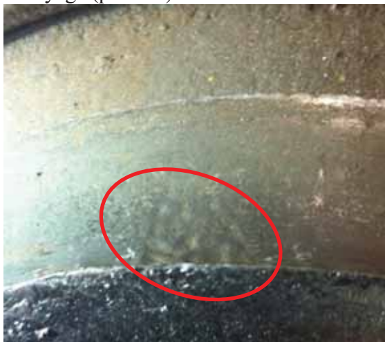
Photo 7: Défaut de surface n°2 avant nettoyage
