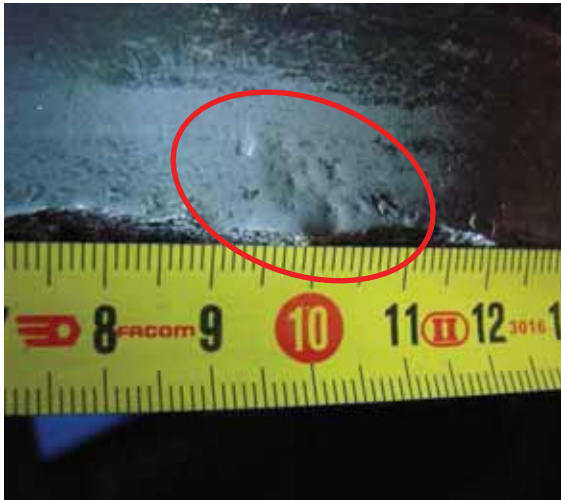
Photo 11 : Défaut de surface n°3 avant décapage
