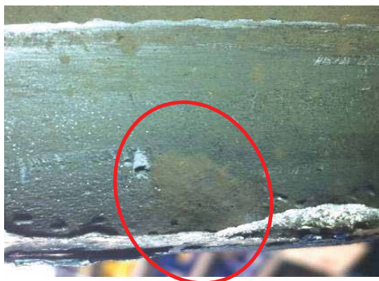
Photo 10: Défaut de surface n°3 avant nettoyage
