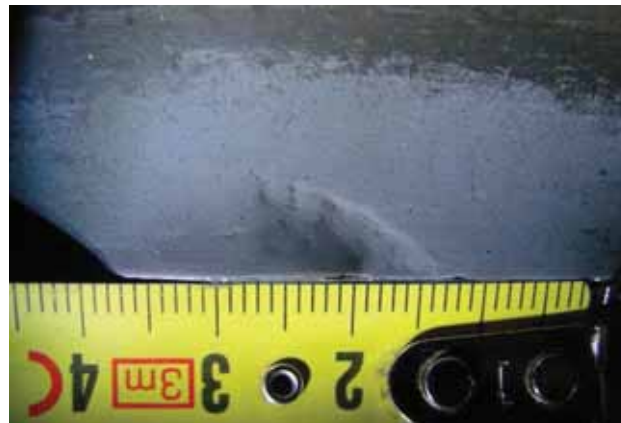
Photo 4: Défaut de surface n°1 avant décapage
