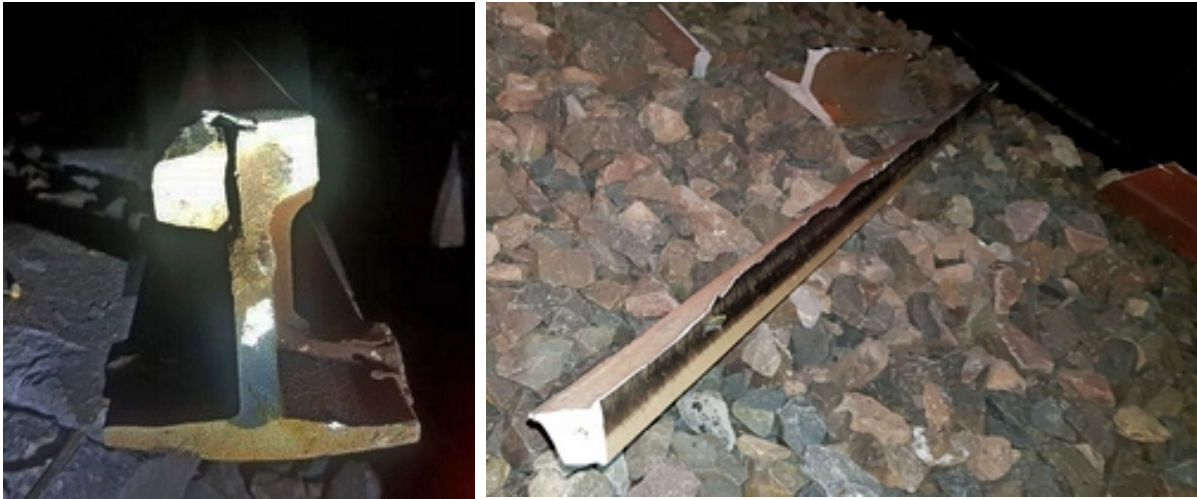
Vues de fissurations verticales longitudinales du rail A gauche : fin de la fissuration verticale sur la soudure À droite : demi champignon du rail tombé à l'extérieur de la voie – Photos SNCF Réseau
