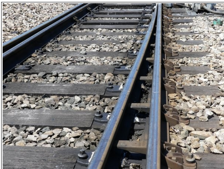
Figure 16 : aucune trace de roue entre la PRA et la dernière butée
