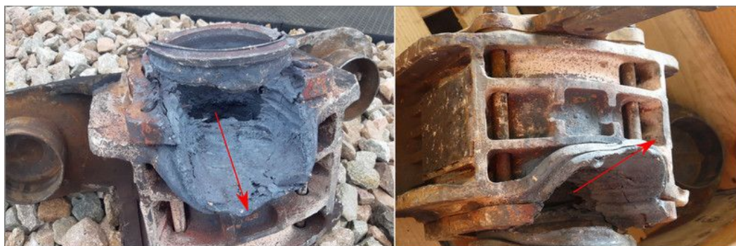
Figure 32 : Vue de haut de la boîte « fondu » montrant la sortie « par le haut » de la fusée d'essieu rompue (Source BEA-TT)
