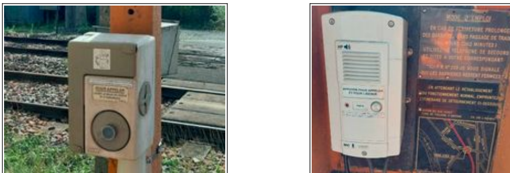
Figure 39 : exemples d'équipements installés au PN 238 (à gauche) et PN 239 (à droite)
