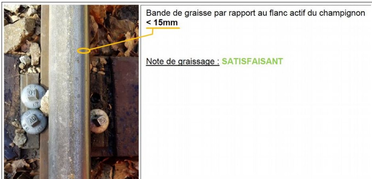
Fig 38 : État du rail au pk 22,550 sur la file haute : graissage satisfaisant (source : SNCF)
