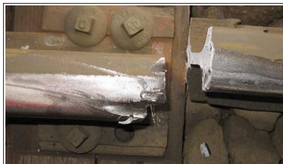
Fig 43 : Train déraillé en 2009 et rail cassé (source SNCF)
