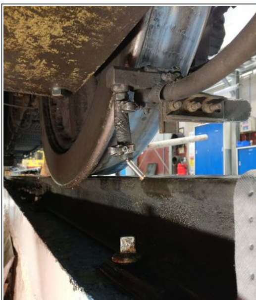
Fig 65 : Graisseur de rail installé sur une Z100 en position normale (photo BEA-TT)
