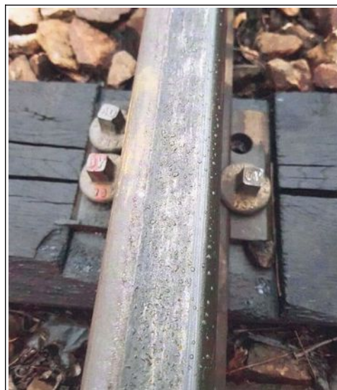
Fig 44 : État du dessus du rail au pk 12,700 file droite (photo SNCF)
