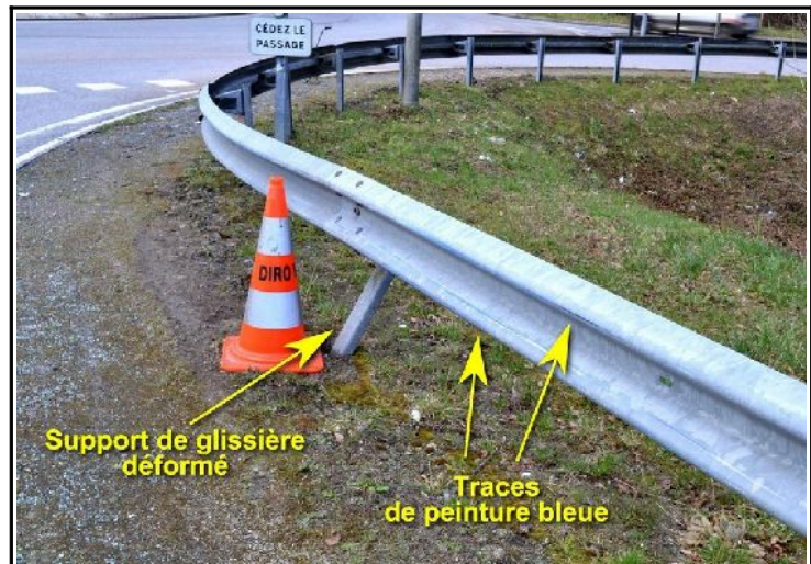
Figure 14 : Vue rapprochée des dégâts occasionnés à la glissière située sur le côté droit de la bretelle de sortie
