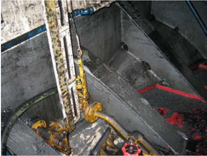
Vanne de caisse à combustible avec commande fermeture à distance
