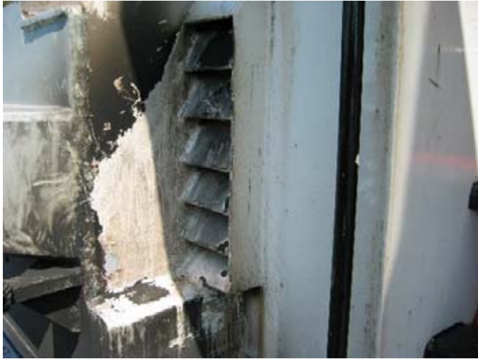
Entrée d'air bâbord du compartiment machine
