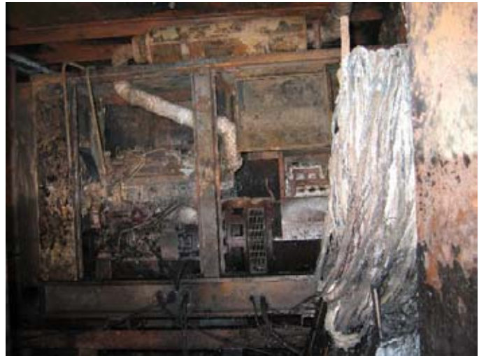
Groupe électrogène tribord après l'incendie
