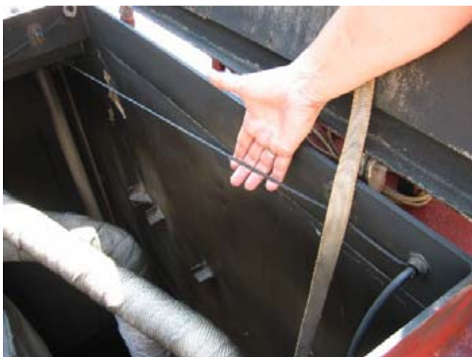
Câble de commande de fermeture à distance de vanne de caisse à combustible dans l'échappée machine
