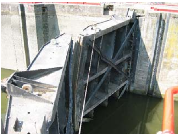
Domages à la porte de l'écluse
