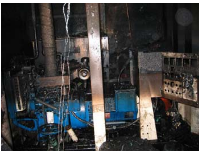
Groupe électrogène bâbord après l'incendie
