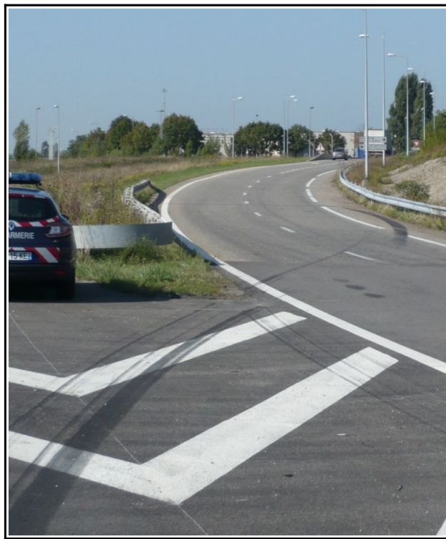
Figure 20 : Traces de pneumatiques visibles sur la chaussée de la bretelle de la sortie n° 20
