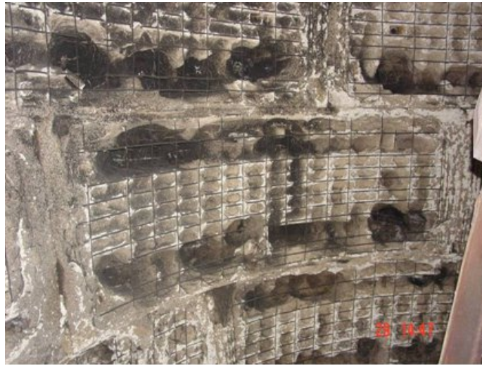
figure 35 : Dégâts subis par le revêtement du tunnel au niveau de la voûte du tunnel
