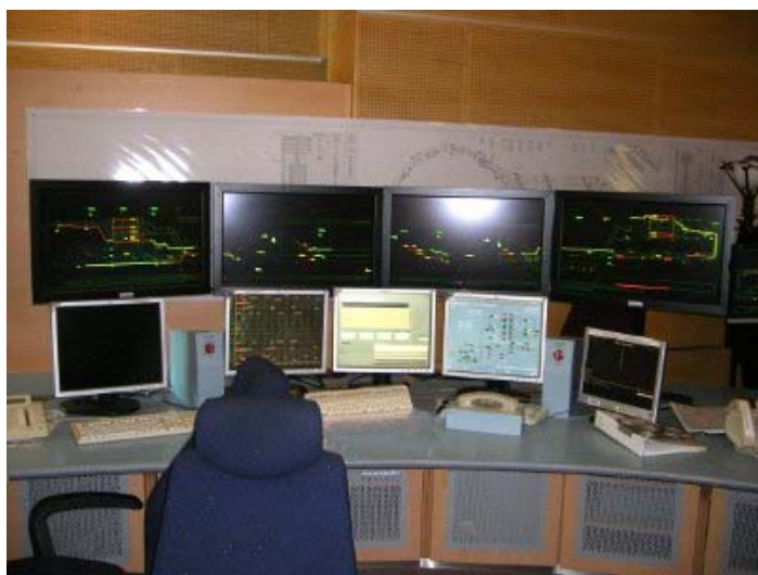
figure 15 : poste de travail du contrôleur ferroviaire (RTM) au RCC, côté France
