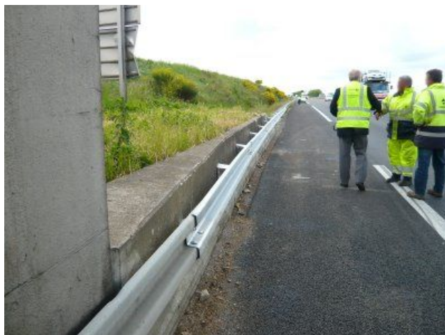
Le raccordement de la glissière métallique (type GS2) et de la barrière en béton (type GBA)
