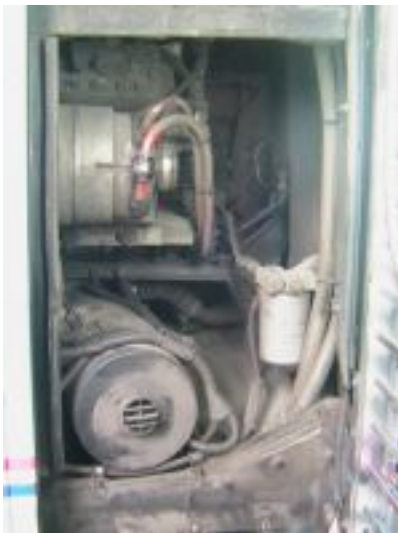
Photo 13 - Compartiment arrière droit
