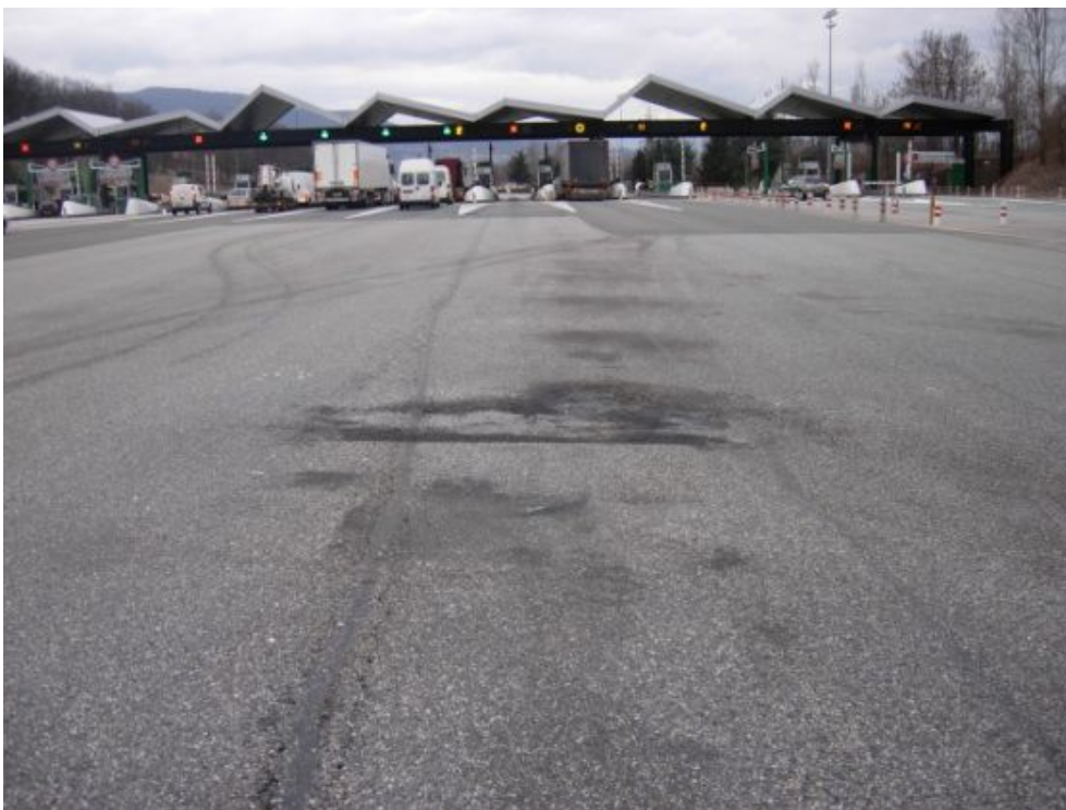
Figure 4 - Lieu de l'incendie près de la barrière de péage de Chignin
