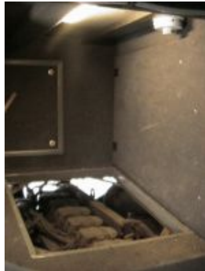
Photo 21 Détecteur soute à bagages
