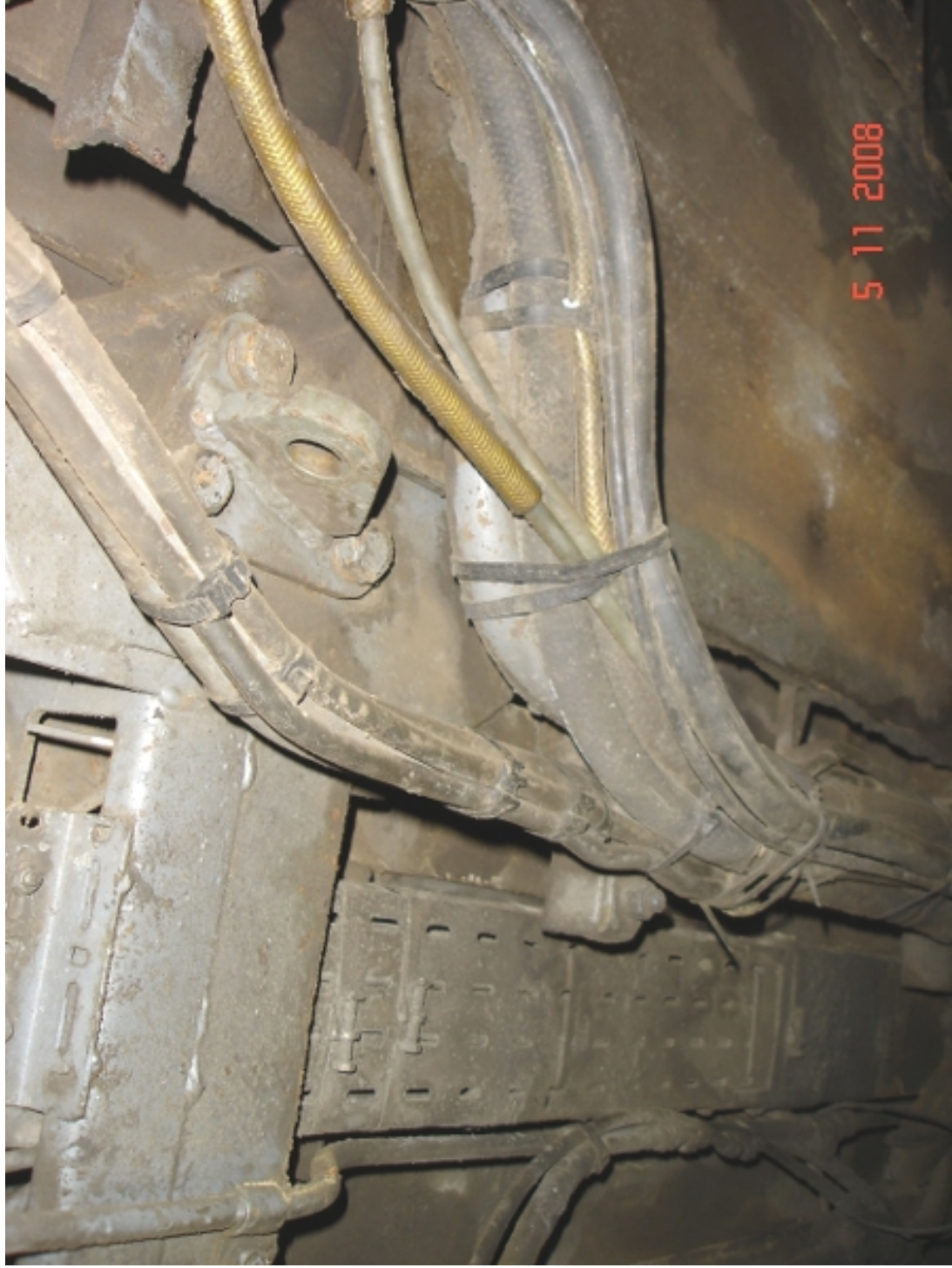
Annexe 7 : Câblage électrique sous caisse
